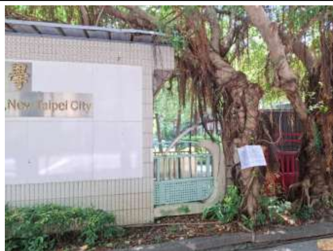
修剪計畫 編號 1 、樹木平台編號 014812-746655 因損及建物結構，建議移除。
